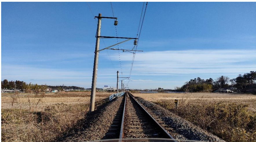
④電気施設関係 【丸森～角田 コンクリート柱の傾斜】
