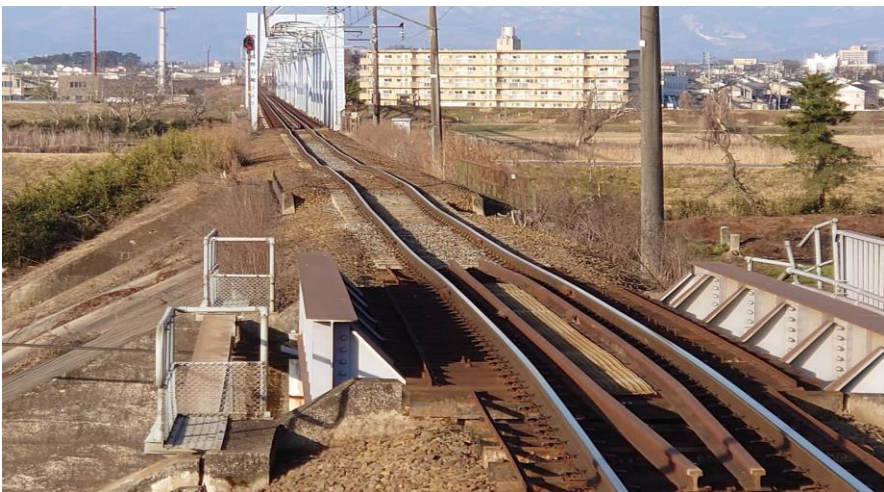
②線路施設（軌道）関係 【瀬上～高子 浮きマクラギ状態】
